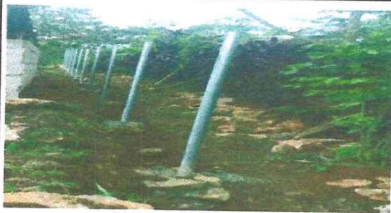
Foto 3: VISTA LATERAL DE LOS TUBOS GALVANIZADOS DE LA MALLA PERIMETRAL DEL PREDIO ESCOLAR. 11/06/2024
